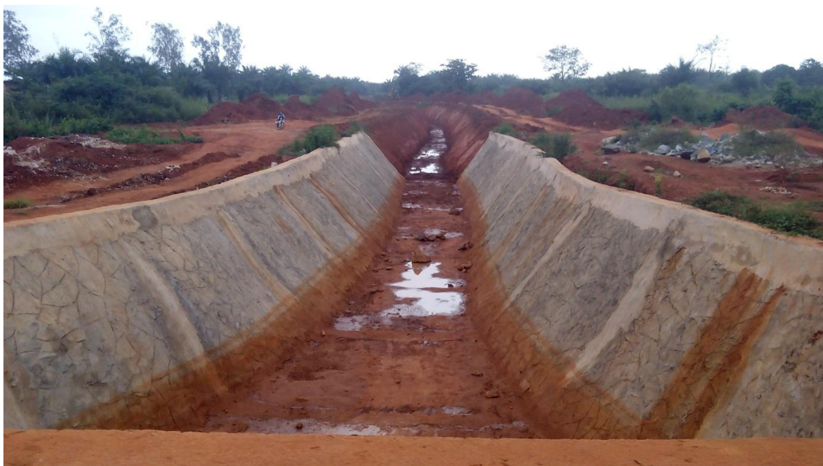
Collecteur d'assainissement de crête à Bohicon, département du Zou
