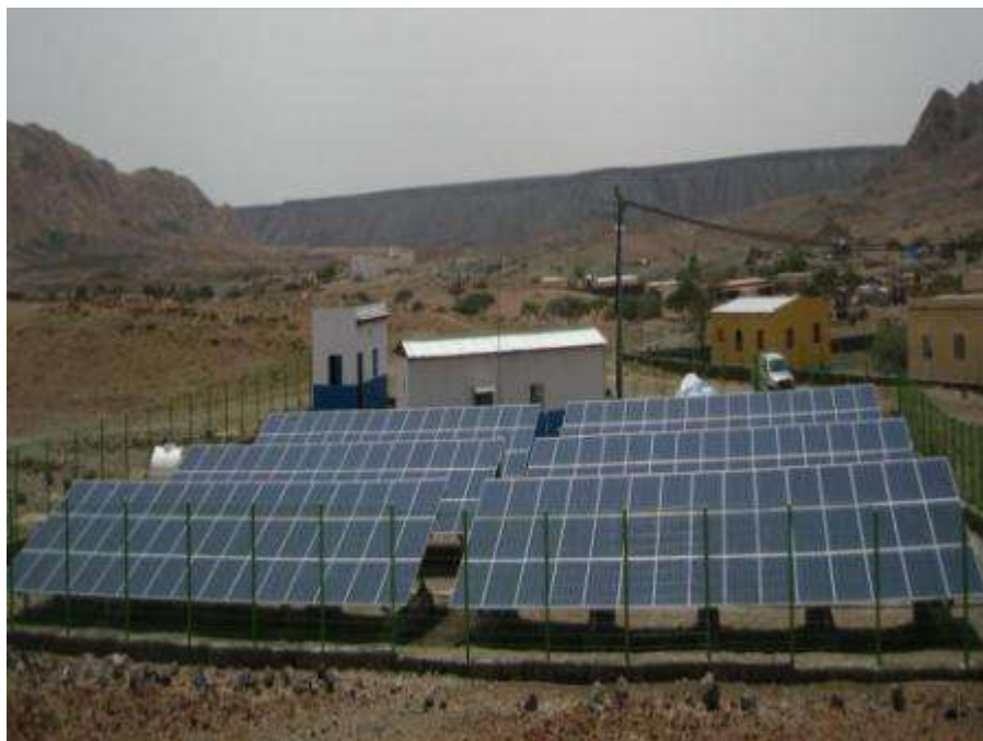
Champ de panneaux solaires
